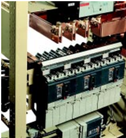
Стационарные, установленные вертикально автоматические выключатели Compact NS 100-250, подключенные к силовым шинам через распределительный блок Polypract
