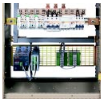
Digipact Концентратор данных DC150, блок индикации и местного управления CLS150, установленный на перфорированной плате в задней части щита
