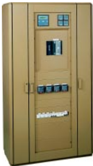
Digipact Измеритель мощности PM 100, блок индикации и местного управления CLS 150 на передней панели распределительного щита
